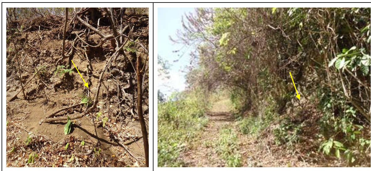
Figura 13: Inestabilidad de taludes en la finca
